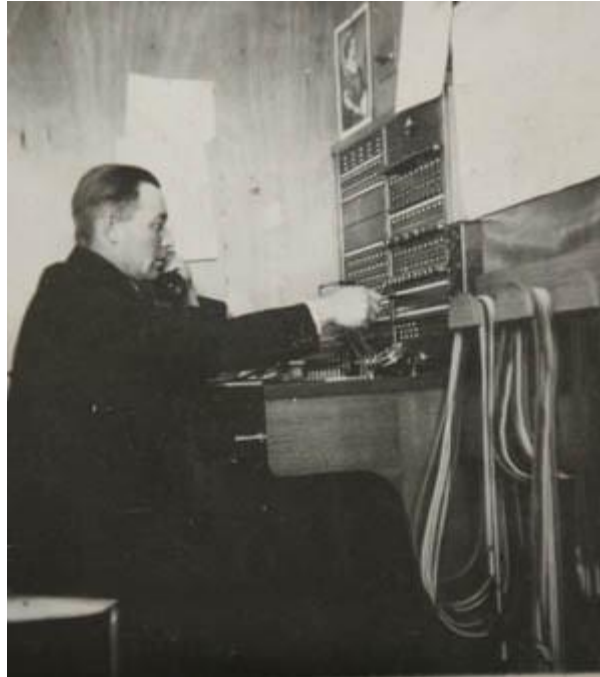
PGEM'er Jan Griess achter het zogeheten multipelveld op de centraalpost in de Grutstraat.
